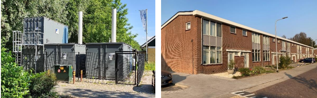
Figuur 1.2: Een tijdelijke energiecentrale vormt nu de bron van het warmtenet waarop Tablis Wonen is aangesloten, voordat er op geothermie wordt overgeschakeld. Daarnaast zijn de aangesloten woningen extra geïsoleerd, zoals rechts op de foto.
